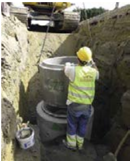
De ruim 100 inspectieputten in zelfverdichtend beton dienen voor occasionele inspectie en reiniging, maar ook voor het aanbrengen van hoekverdraaiingen in het leidingstelsel.
