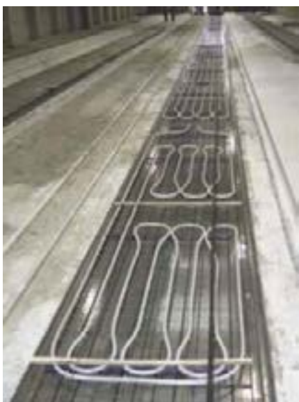
Fig. 6: Holle vloeren met ingebetonneerde waterleidingen voor verwarming en koeling Fig. 6: Plancher alvéolé comprenant des conduites d'eau pour chauffage et refroidissement.
